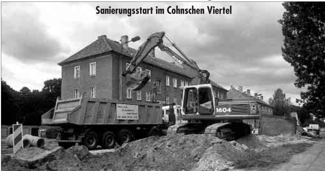
Schwere Technik im Einsatz. Die Sanierung der Nauener Straße geht zügig voran.
